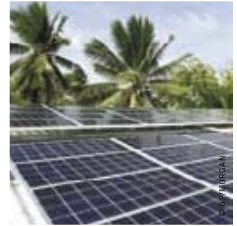
Bild SOLARKOLLEKTOREN AUF EINER KÜHLANLAGE (ZUR KÜHLUNG VON FISCHWAREN). LIKIEP ATOLL, MARSHALL INSELN.
